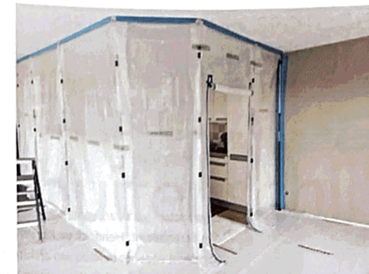
Omdat de open keuken bereikbaar moest blijven, werd deze afgeschermd met een herbruikbare stofwand van Curtain-Wall
